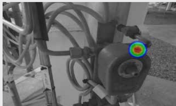
A FLIR Si124 segítségével talált sűrített levegő-szivárgások kijavítása évente több tízezer dollárnyi áramköltséget takaríthat meg a gyártóknak.
